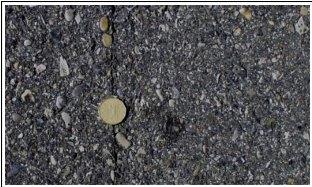
Photo 10 : Gros plan de la fissure capillaire le long du trait de scie du joint longitudinal dans la section d'essai de liant classé selon le rendement (~2+110) (représente également la section de contrôle) - Septembre 2000
