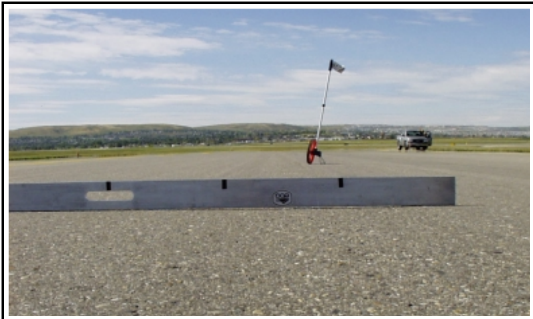
Photo 6 : Très faible dépression le long d'un joint longitudinal et problèmes mineurs de déchaussement et de désintégration dans la section d'essai de liant classé selon le rendement- Septembre 2000
