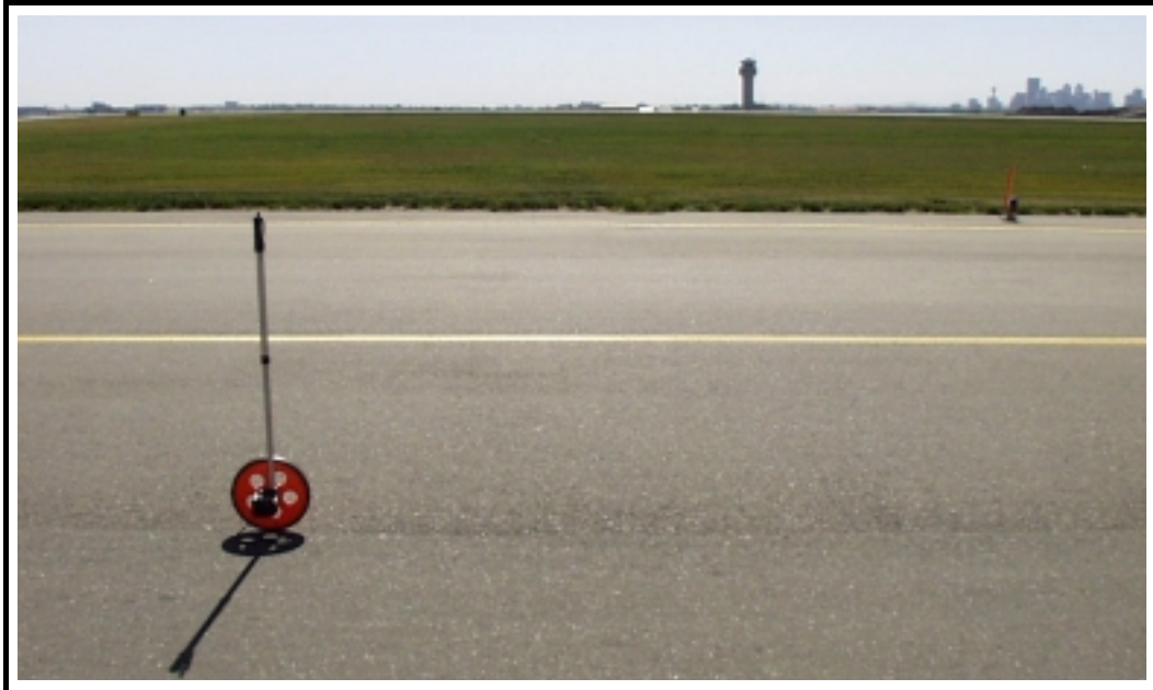
Photo 5 : Problèmes mineurs de déchaussement et de désintégration le long d'un joint longitudinal dans la section d'essai de liant classé selon le rendement Septembre 2000
