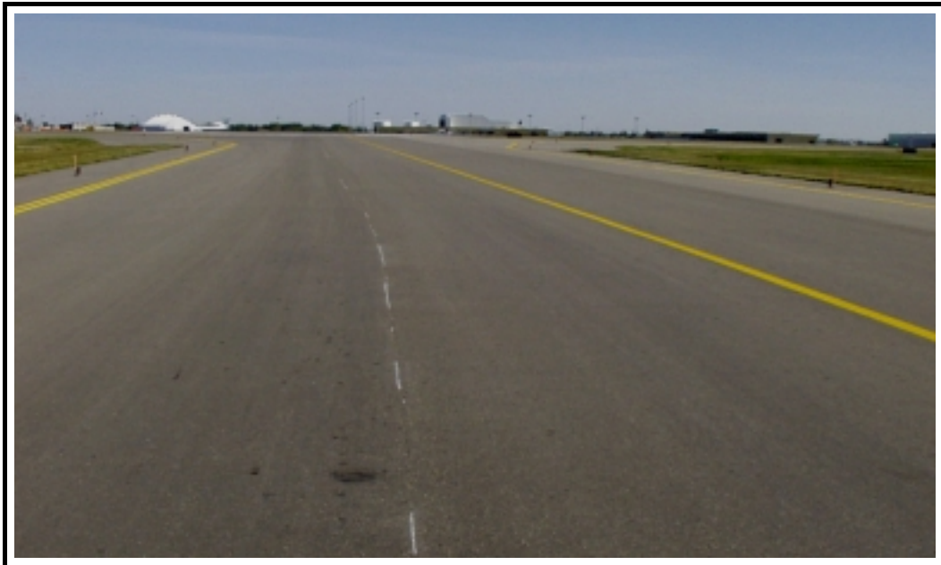
Photo 4 : Problèmes mineurs de déchaussement et de désintégration le long d'un joint longitudinal dans la section d'essai de liant classé selon le rendement. Fissure capillaire indiquée à la craie le long du joint longitudinal - Septembre 2000
